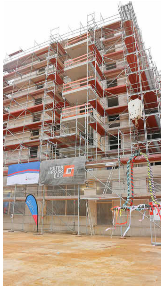
Im November 2022 war es soweit und die Bauarbeiten für die Mainhöhe wurden mit dem Richtfest offiziell begonnen. Foto: ana
