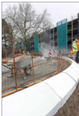
Eine Straßenseite wird bereits von ersten Borden für den späteren Gehweg gesäumt.
