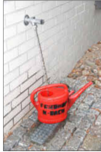
Auch im Winter verlässlich frostsicher: die neue Zapfstelle für Gießwasser. Foto: (wö)
