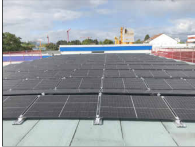
Der neue Stolz des KKB: die Photovoltaikanlage, die aktuell 36 Prozent des Strombedarfs deckt.
